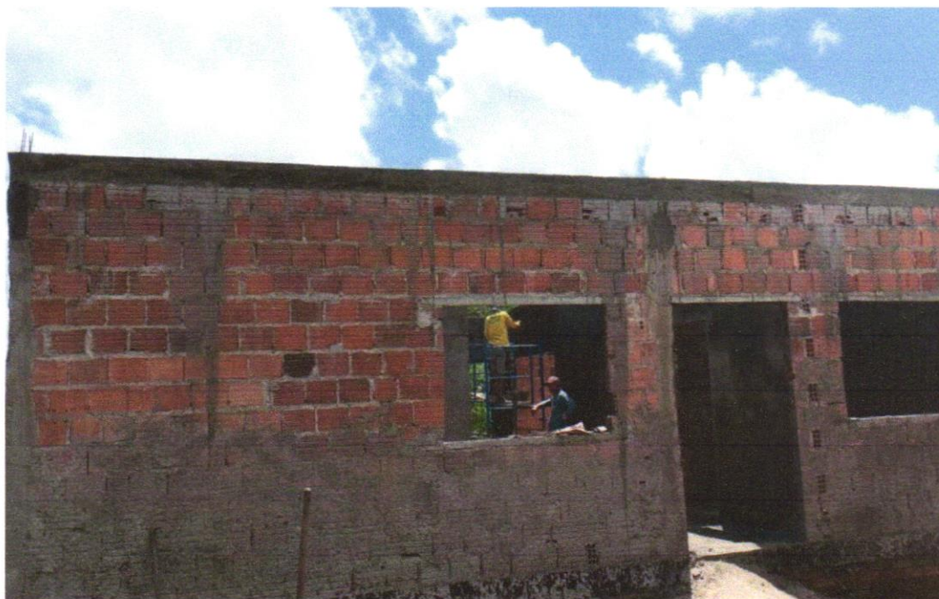
FOTO 13 - (COMPOSIÇÃO REPRESENTATIVA) EXECUÇÃO DE ESTRUTURAS DE CONCRETO ARMADO, PARA EDIFICAÇÃO HABITACIONAL UNIFAMILIAR TÉRREA (CASA EM EMPREENDIMENTOS), FCK = 25 MPA. AF_01/2017
