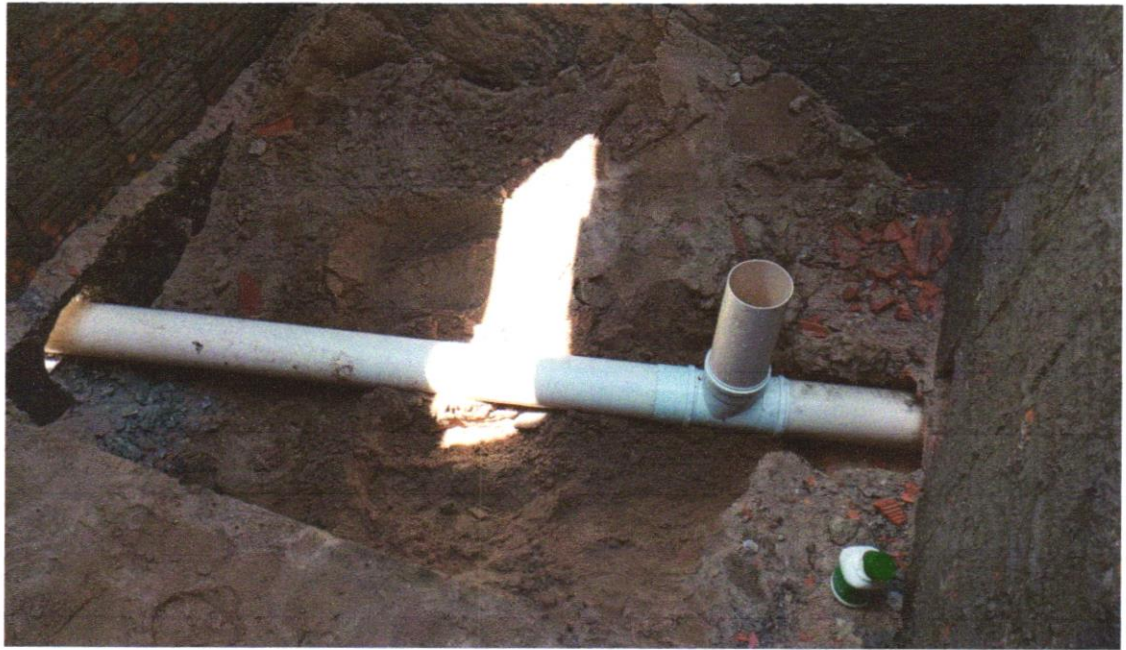
FOTO 11 - TUBO PVC, SÉRIE R, ÁGUA PLUVIAL, DN 100 MM, FORNECIDO E INSTALADO EM RAMAL DE ENCAMINHAMENTO. AF_06/2022
